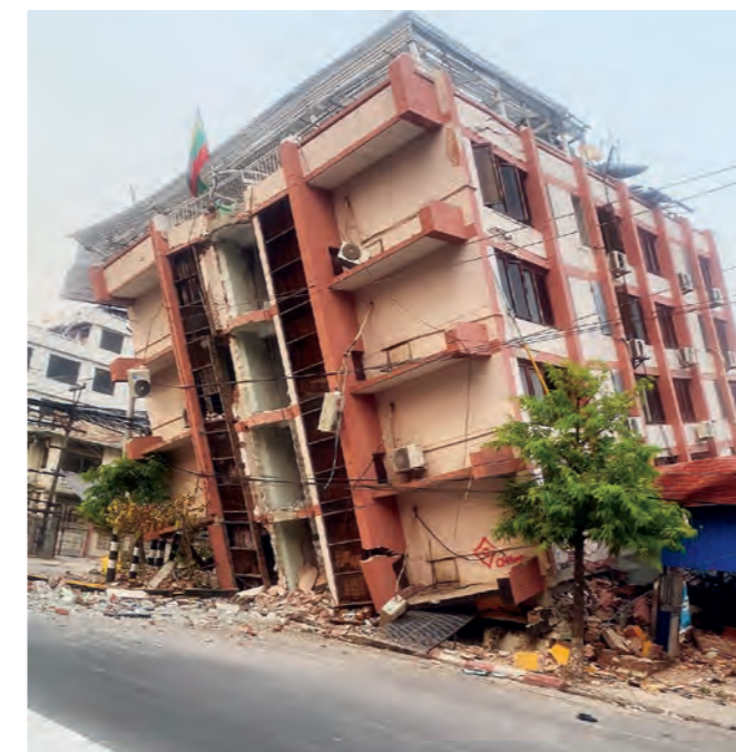
Eines der vielen eingestürzten Häuser
